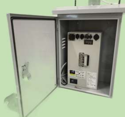
非常用蓄電池付 ソーラー外灯
